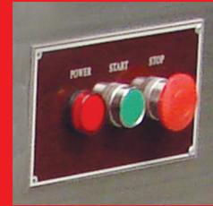
Seguridad eléctrica: - Parada de Emergencia - Relay térmico
