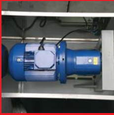
Transmisión con motorreductor
